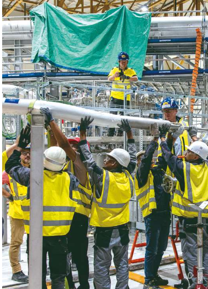
▲ Un banc de test à l'intérieur de l'usine cryogénique permettra de tester des cryopompes dans les mêmes conditions de température et de pompage que celles attendues lors de la phase opérationnelle de la machine ITER.
