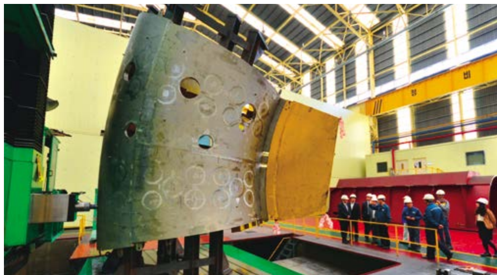
Un des neuf secteurs de la chambre à vide fabriqué en Corée du Sud.
